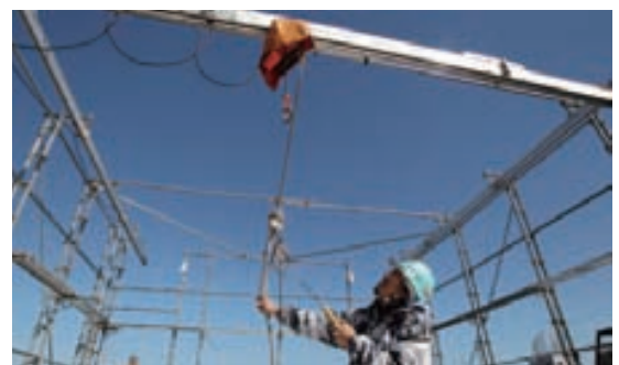
足場上部に現場仮設型天井クレーンを設置し、躯体・外装工事を施工する、オリジナルの「ガータークレーン」
