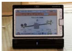
毎日、発電量などをCO 2 モニターで確認(平成20年度住宅・建築物省CO 2 推進モデル事業の一環)
