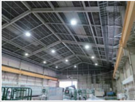
（節電対策）照明のLED化
