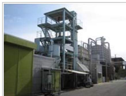
（浅井工場）木質バイオマス・ガス化発電装置
