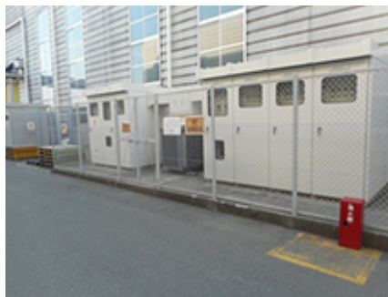
高圧トランスの高効率化
