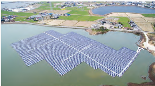
水上ソーラーシステム
