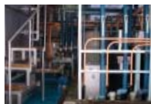
総合排水処理槽
