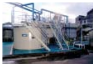
原水槽と防液堤
