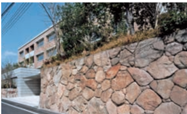
大正の頃から続く閑静な邸宅街、山手町。既存の野面(のづら)石積みを残し、街並みが育んできた歴史を継承した外構は、周辺の風景と自然につながります。(GM芦屋山手町/兵庫県)
